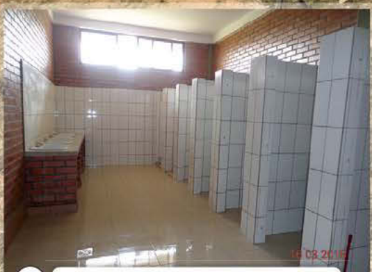
18 Sanitarios con tratamiento de aguas servidas
